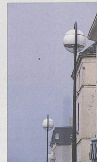
Un lampadaire : de 13 000 F à 18 000 F suivant le type (tranchées et câbles d'alimentation compris). A titre d'exemple, le coût global d'un lampadaire, rue Jean-Jaurès, s'élève à 18 000 F.
