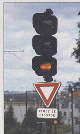
Un feu tricolore implanté à un carrefour : 40 000 F (cablage, commande et régulation compris).
