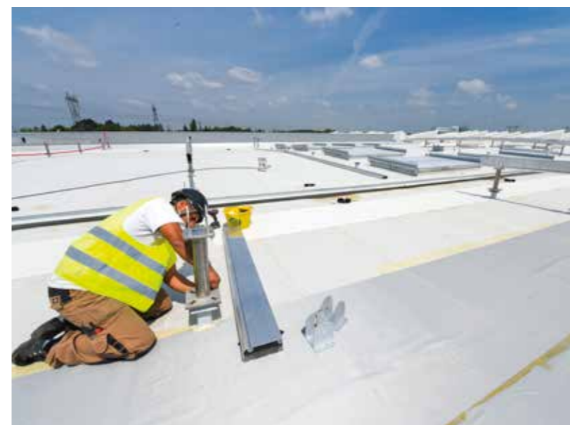
La plus puissante installation solaire du Grand Ouest sera sur le toit du MIN.
